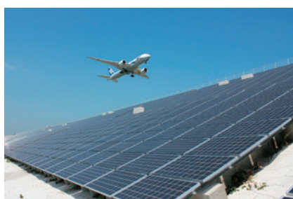
岡山空港太陽光発電所
