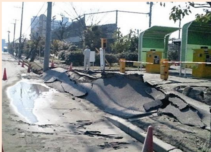
道路被害（気象庁提供）
