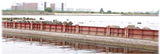
潮止堰に設置した防潮パネル
