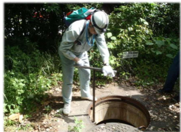
2ルート配水体制時のバルブ操作の確認
