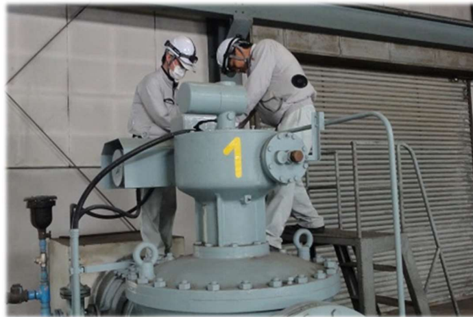
配水ポンプの巡視点検
