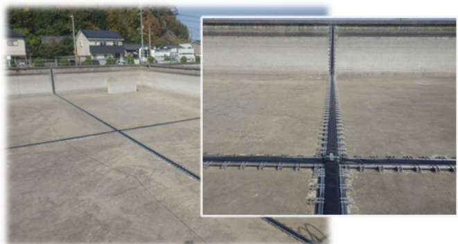
配水池の耐震補強：後付型伸縮可とう継手
