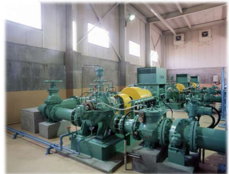
塩生加圧ポンプ場
