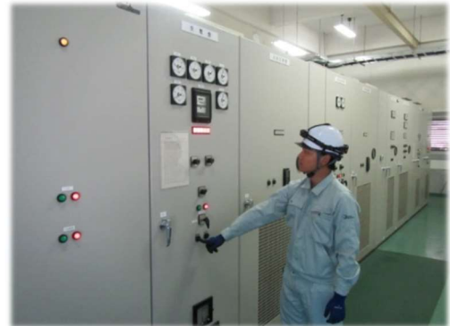
高圧受電設備の巡視点検
