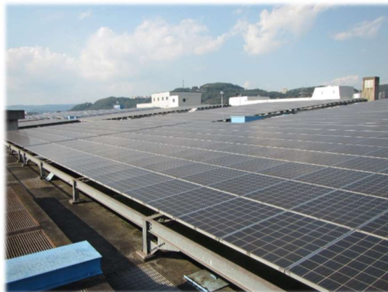
鶴新田浄水場 太陽光発電システム
