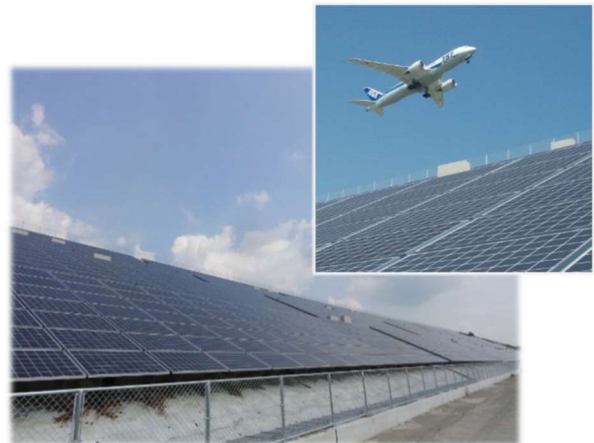
岡山空港太陽光発電所
