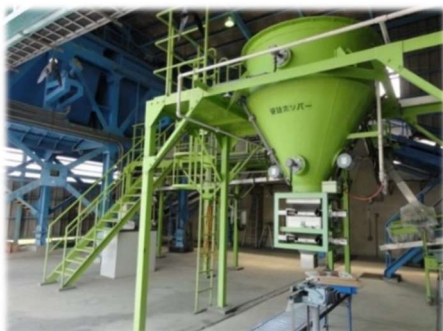
汚泥処理設備
