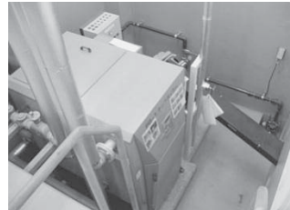
木質チップ焚き温水ボイラー
