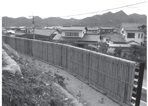
落石防護壁の緩衝材 (和気町衣笠地区内)
