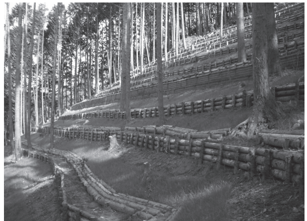
丸太筋工 (高梁市備中町地区内)
