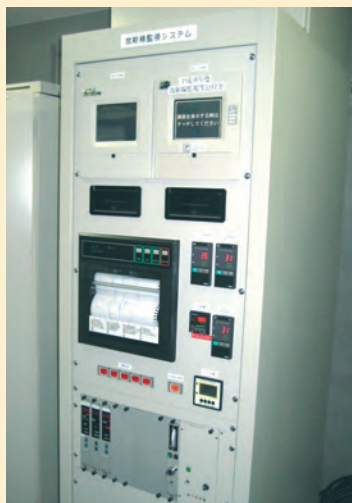
空間ガンマ線測定装置
