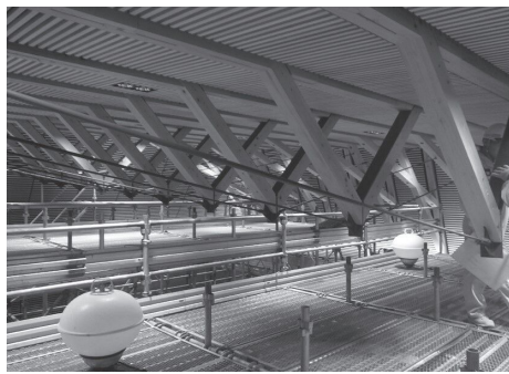
新庁舎建設状況[議会棟天井部] (構造材はH鋼と美作市産材の組み合わせ)
