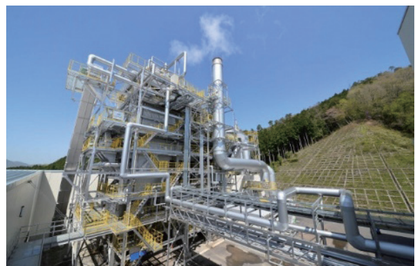
▲ 木質バイオマス発電所
