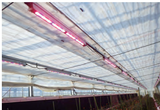
高輝度LEDの設置状況
