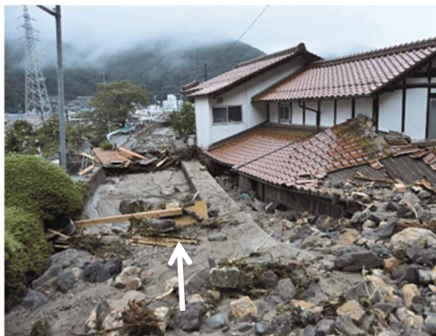
被災状況（今井谷川）
