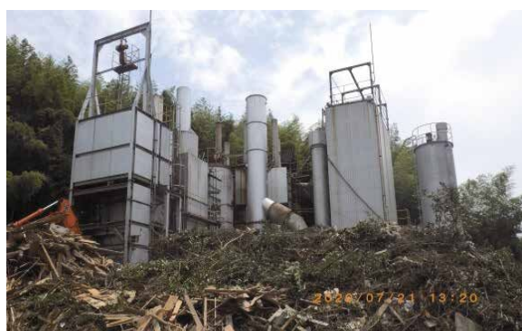
産業廃棄物処理施設（木くずの焼却施設）
