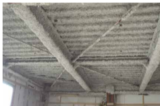
(アスベストが吹き付けられた天井)
