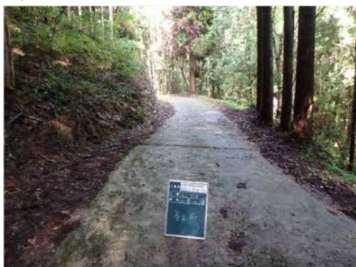
林道法面の改良による走行安全性の確保（改良前）
